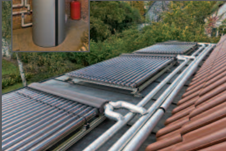
Thermische Solaranlage mit Röhrenkollektoren
