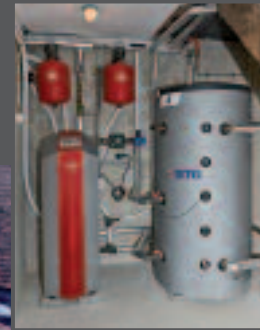
Wärmepumpe mit Warmwasserspeicher
