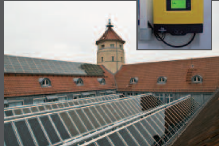
Photovoltaik auf Sheddach im Innenhof
