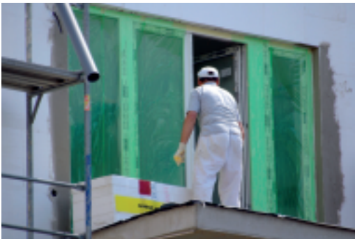
Sanierungen beeinflussen die Dichtheit der Gebäudehülle.
