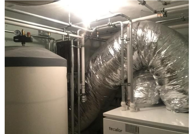
Monoblock Luft-WP im Gebäude
