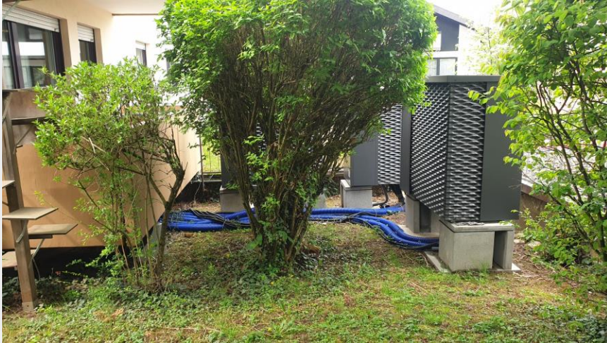
Quelle: Berner Elektrotechnik GmbH
