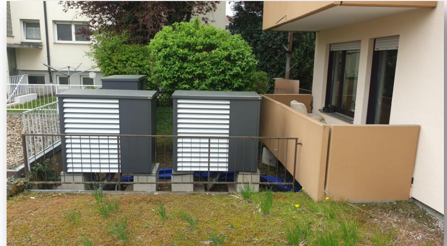
Quelle: Berner Elektrotechnik GmbH
